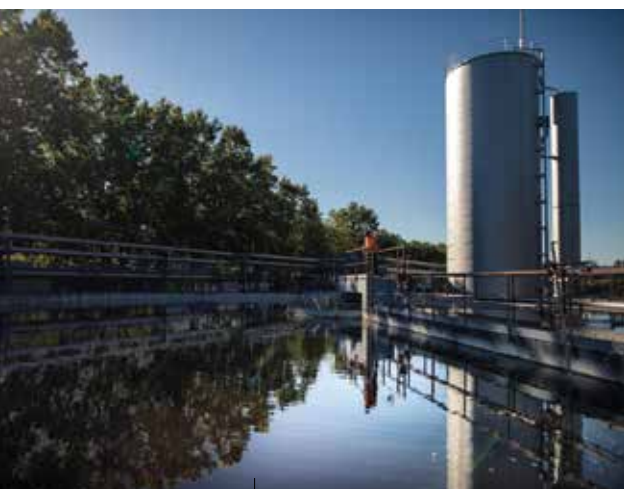
Traitement secondaire des eaux de process.
