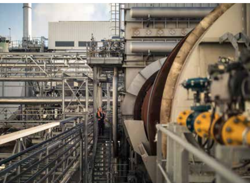
Installation de production d'énergie à partir de Combustibles Solides de Récupération (CSR).
