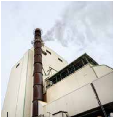
Chaudière et son installation de traitement de fumées.
